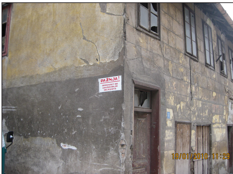
Ruševni objekat u ulici Zvijezda
