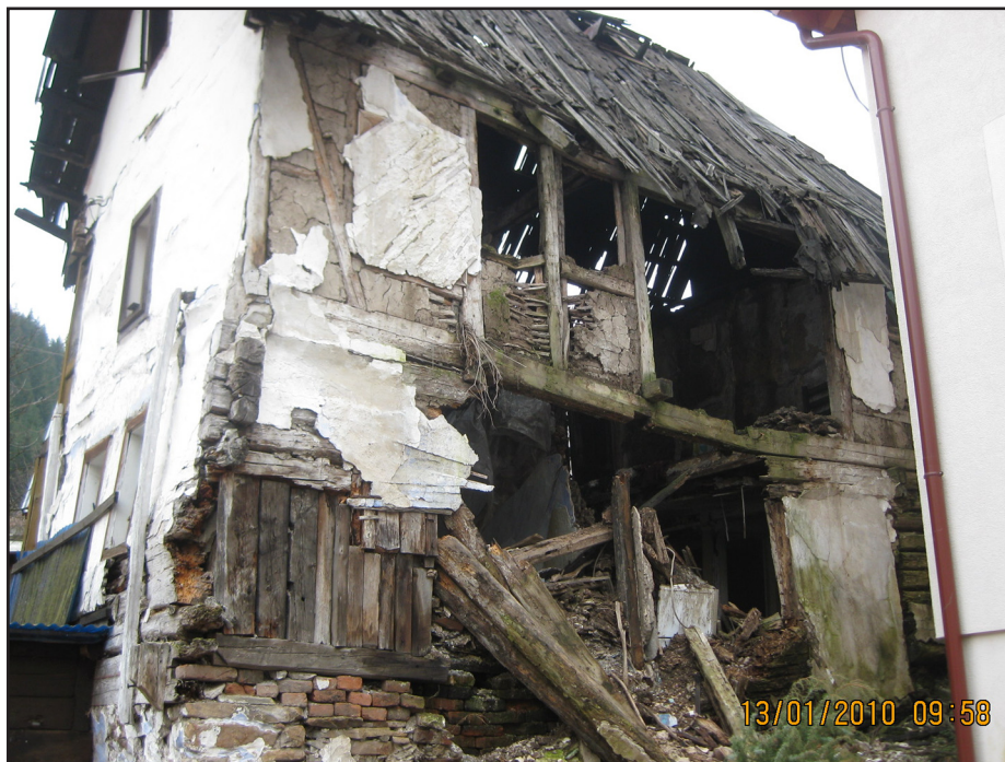
Ruševni objekat u ulici Stojkovići
